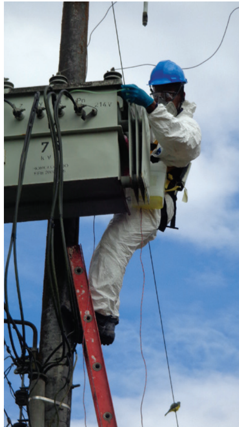
◀ Actividades de diagnóstico de equipos en campo
