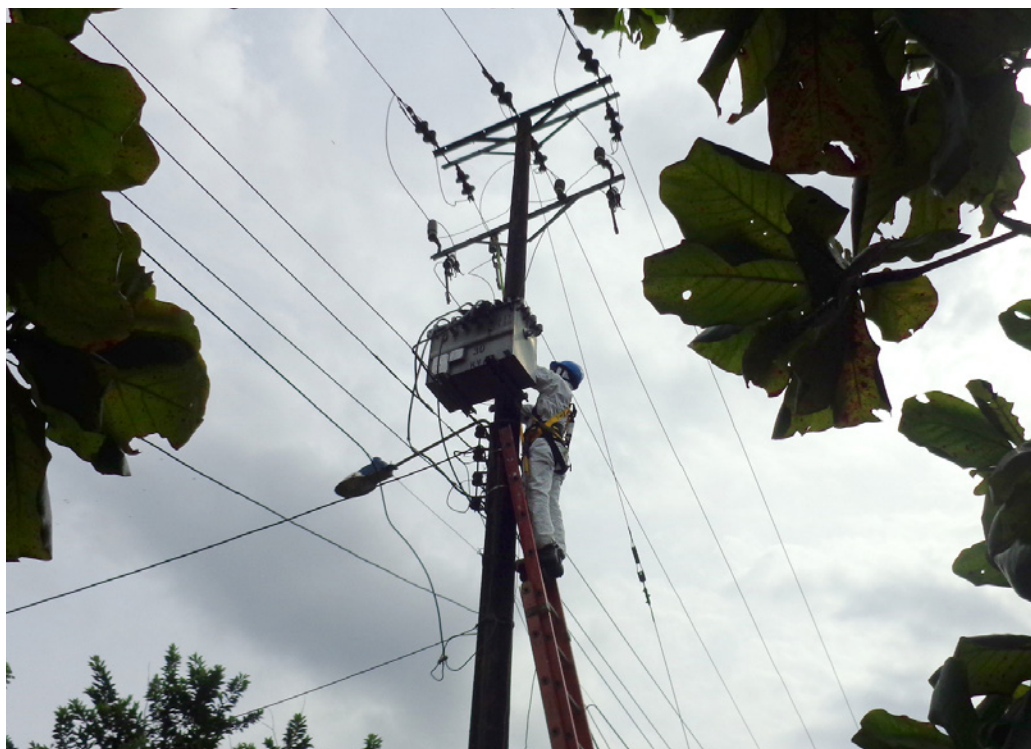
◀ Actividades de mantenimiento de equipos eléctricos en campo
